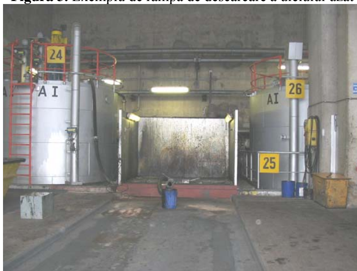
Figura 3. Exemplu de rampa de descarcare a uleiului uzat
