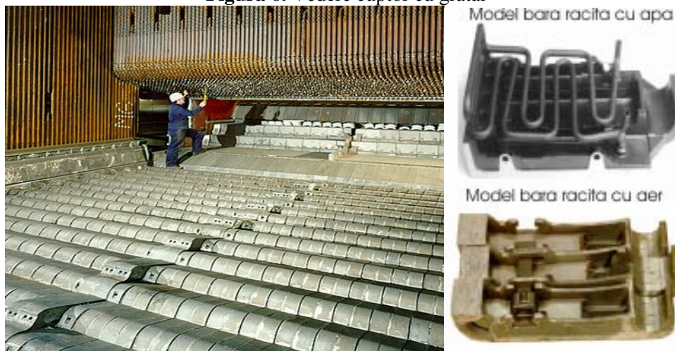
Figura 6. Vedere cuptor cu gratar
