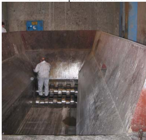
Figura 4. Exemplu de dispozitiv de maruntire a deseurilor voluminoase, chiar in rampa de descarcare
